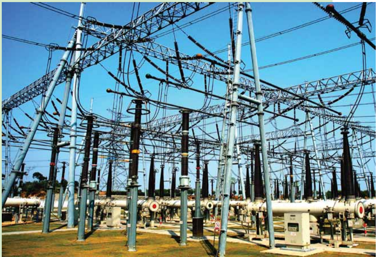
东莞500千伏横沥变电站占地4.5公顷，比常规变电站节约用地一半以上
