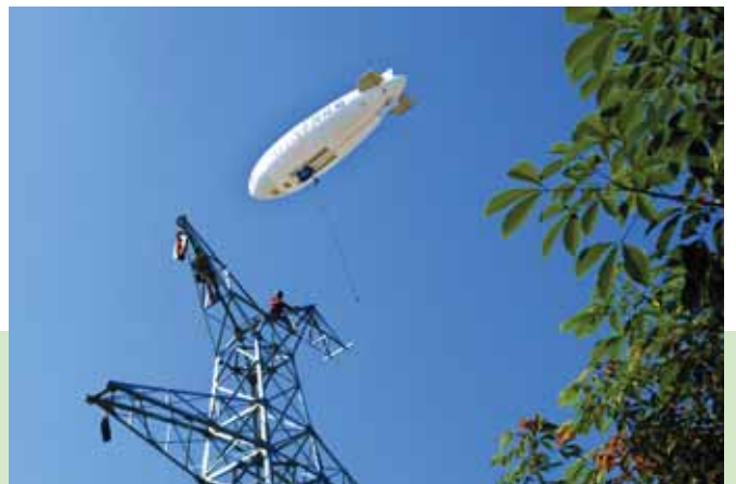
在110千伏云南大渡岗至景洪输电线路建设中，实现国内首次全程采用飞艇放线技术
